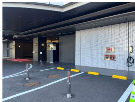
実際の EV 充電器付き駐車スペース
